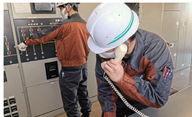
変電所でのシナリオレス訓練
