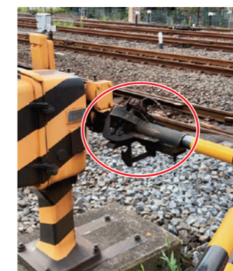
遮断かん折損防止器
