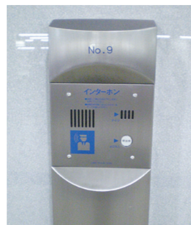
駅ホームの非常用インターホン
